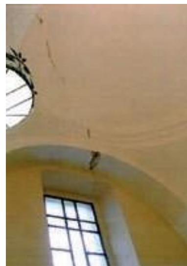
Interno della chiesa: particolare delle lesioni in chiave.
